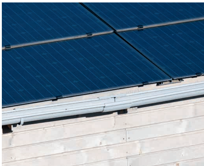
Die Solaranlage unterstützt das ganze System
