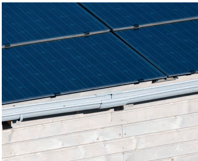
L'installation solaire soutient la totalité du système
